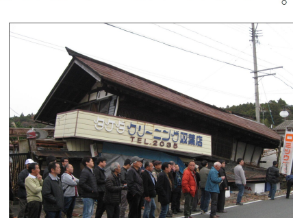
倒壊したままのクリーニング店
